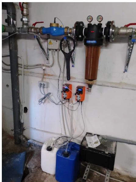
Foto 4 – Impianto clorazione Acqua Fredda
