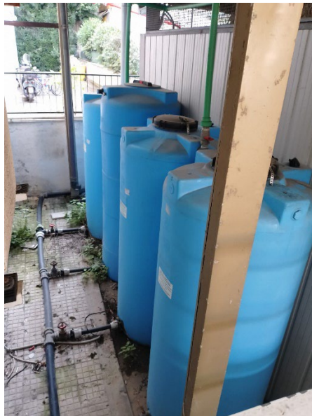
Foto 5 – Serbatoi di accumulo Acqua Fredda
